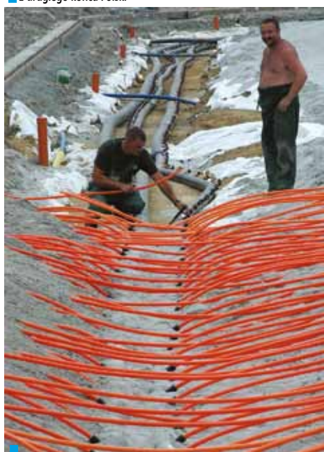
Po wielu latach przerwy Rybnik znów ma podgrzewaną piłkarską murawę. Poprzednia, jeszcze bardzo siemiężna była zasilana energią elektryczną, tą zasilac będzie kotłownia gazowa
