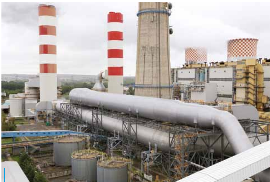
Spaliny z bloków energetycznych są pompowane do instalacji mokrego odsiarczania olbrzymimi rurociągami
